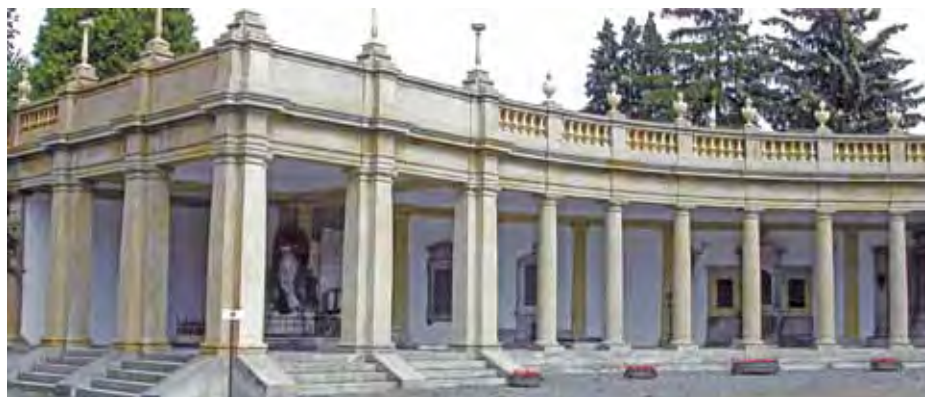
Generální oprava pláště, statická stabilizace a výměna a doplnění štukové výzdoby a celého pláště kolumbaria na Městském hřbitově v Opavě.
